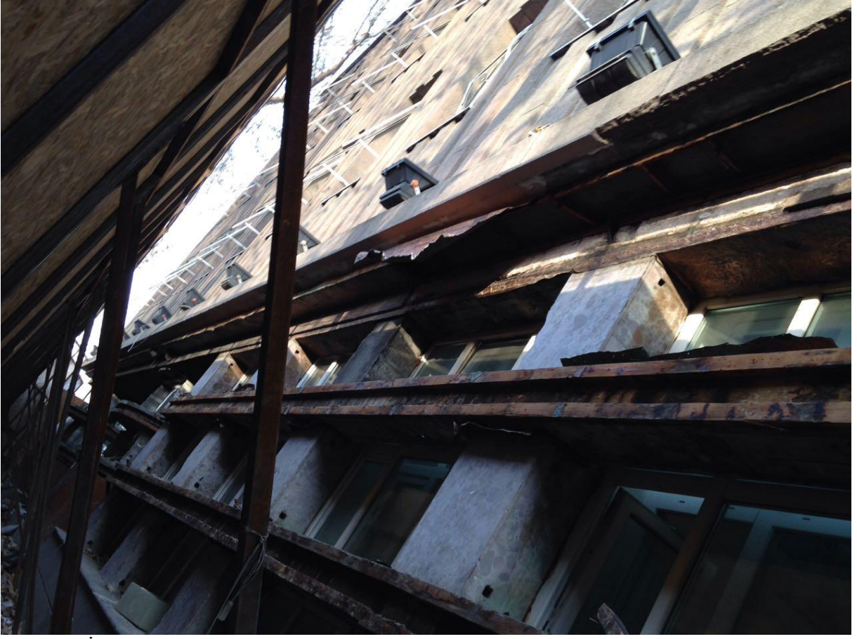
Şekil 26. İller Bankası cephe; şimdiki durum (Ocak 2017)
