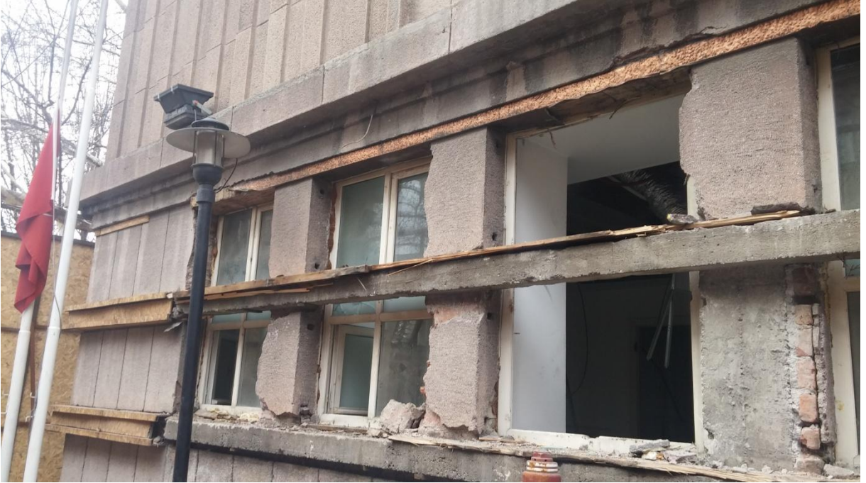
Şekil 27. İller Bankası cephe; şimdiki durum (Ocak 2017)
