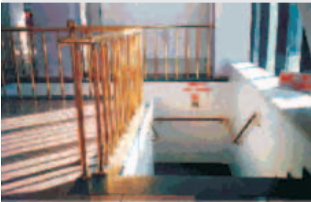
Bazı belediye hizmet binalarında tuvaletler merdivenle inilen zor ulaşılır mekanlarda bulunuyor.
